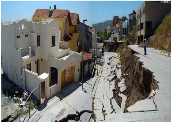
Foto 1. Daño en edificaciones por deslizamiento de laderas en Tijuana, Baja California, México.
