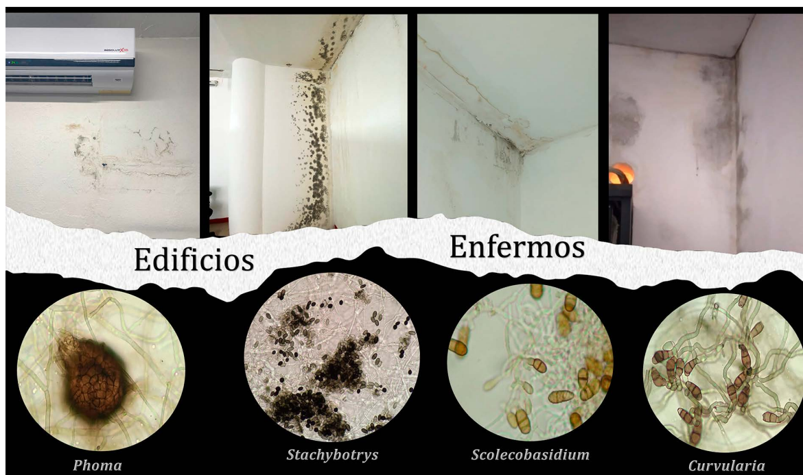
Figura 1. Hongos (moho) desarrollándose sobre superficies construidas.
